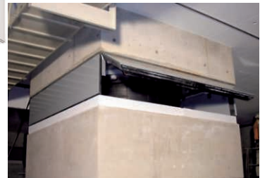
免震装置の耐火被覆
