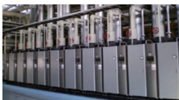
ユーティリティの省エネルギーシステム
