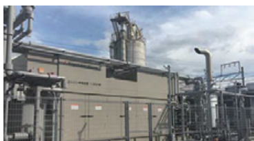
コージェネレーションシステム
