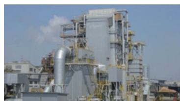
バイオマス発電システム
