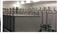
溶媒抽出装置
